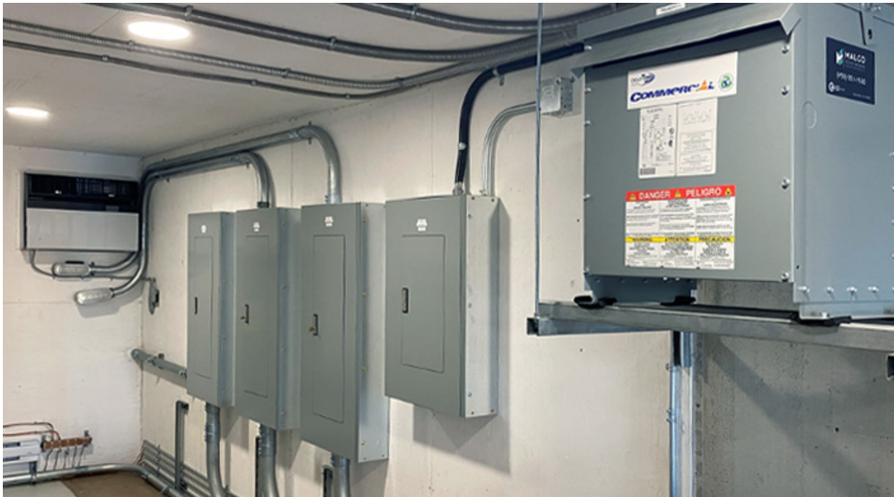
FIGURE 11 • Salle électrique du bâtiment mise à jour pour alimenter l'infrastructure de recharge, Autobus Maheux
